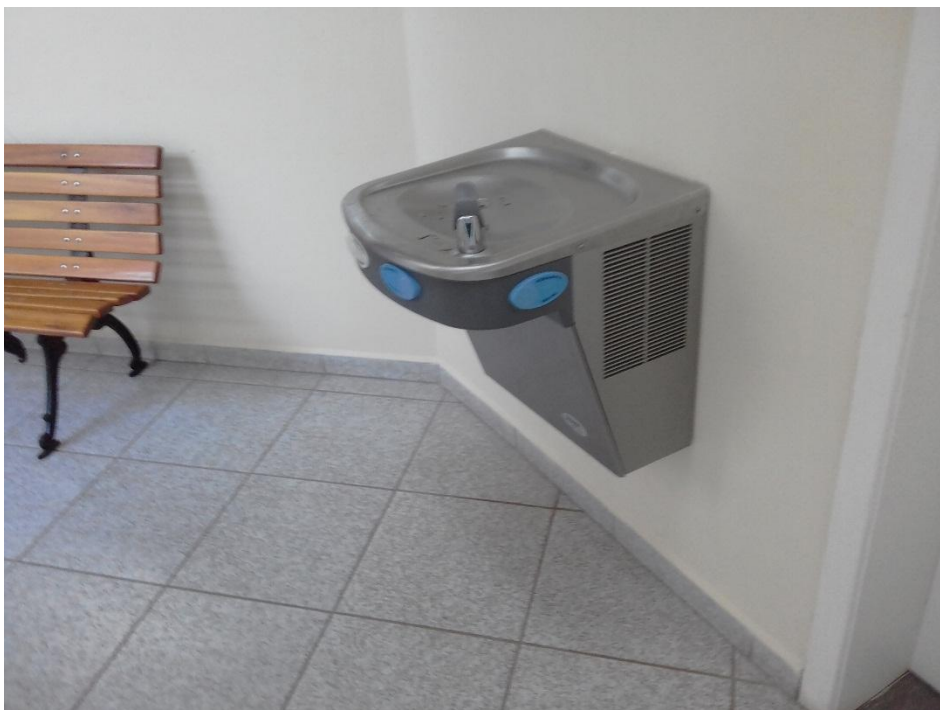
Figura 6 – Bebedouro com acessibilidade é projetado para atender pessoas com deficiência física e mobilidade reduzida.
